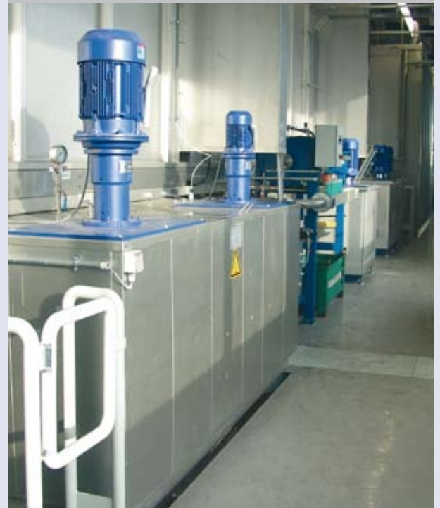
Vorbehandlungsbereich mit Tauchbecken für Entfettung, Beizvor- gang und verschiedenen Spülzonen
